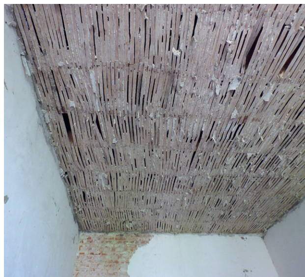
Op de zolder van het bezoekerscentrum en kasteel Lippensgoed-Bulskampveld zijn nog gekliefte latten zonder bezetting te zien.
